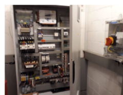
Aufzugsanlage hinter Anlageschalter
