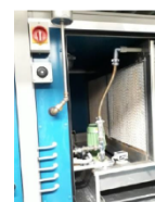
HLK Anlage hinter Anlageschalter
